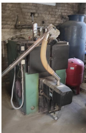
Daudzdzīvokļu mājas katls Inčukalnā
