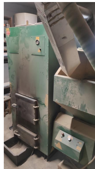
Allažu kultūras nama katls
