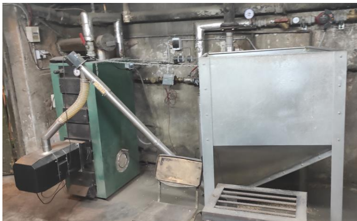
Daudzdzīvokļu mājas katls Kārļzemniekos
