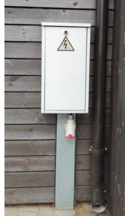
11.2. att. Elektrības ievadskapja ārpusē un iekšpusē
