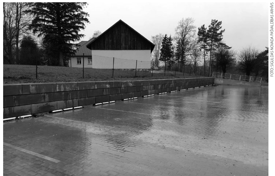
Krimuldā, Saules ielā 1A, sakārtota automašīnu stāvvietā, nostiprinot sienu, līdz ar to stāvvietā atkal ir droši novietot automašīnas.
