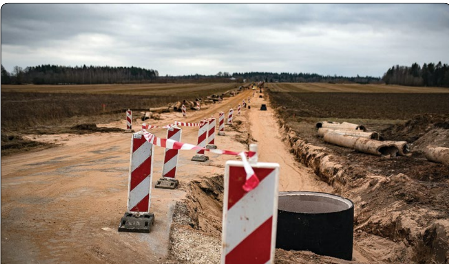
Atsākoties aktīvai ceļu remontdarbu sezonai, aicinām novada iedzīvotājus un viesus sekot līdzi satiksmes organizācijas izmaiņām un ievērot izvietotās ceļazīmes. Šobrīd notiek Limbu ceļa un Lauku ielas pārbūve, ceļu remontdarbus vairākās vietās novadā veiks arī VSIA "Latvijas Valsts ceļi". Šogad Siguldas novadā plānots ar dubultās virsmas tehnoloģiju apstrādāt 28 ielu posmus, par ko informācija publicēta "Siguldas Novada Ziņu" marta izdevumā.
