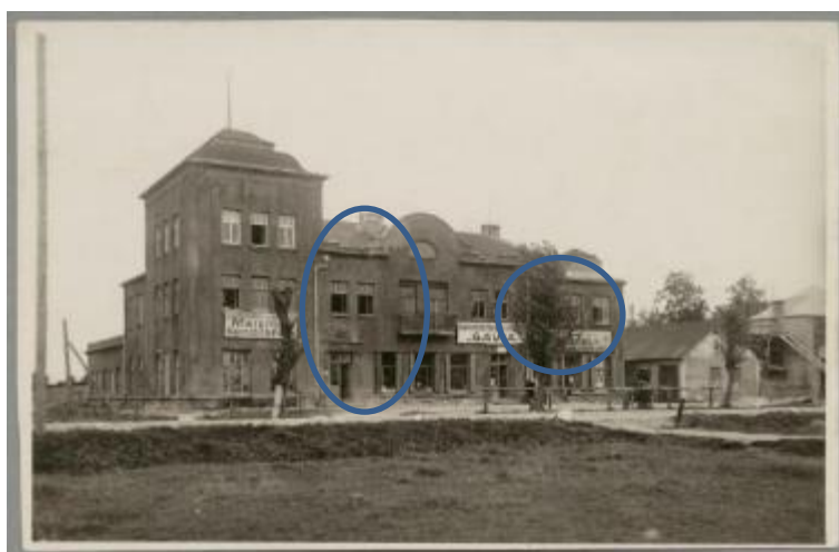
Attēls 89 Vēsturiskais lukturis un vēsturiskā lietusūdens noteka pie fasādes ēkai Siguldā, Ausekļa ielā 7. Vēsturiskā fotofiksācija [Turaidas muzejrezervāta arhīva materiāls]
