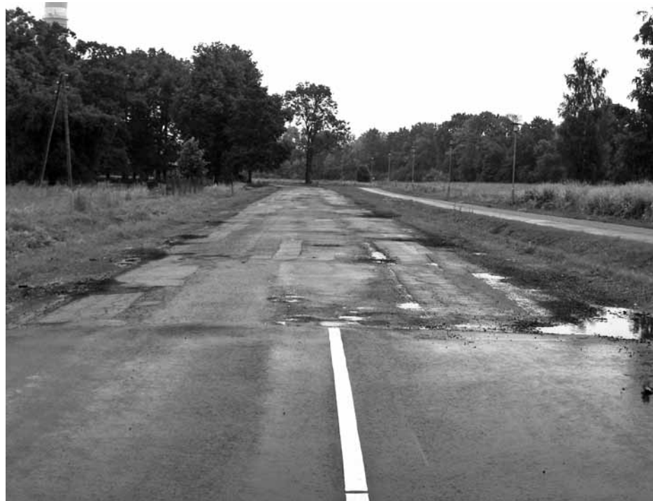
Šovasar tiks uzsākta asfaltseguma rekonstrukcija Televīzijas ielas posmā no Dārza līdz Līvkalna ielai
