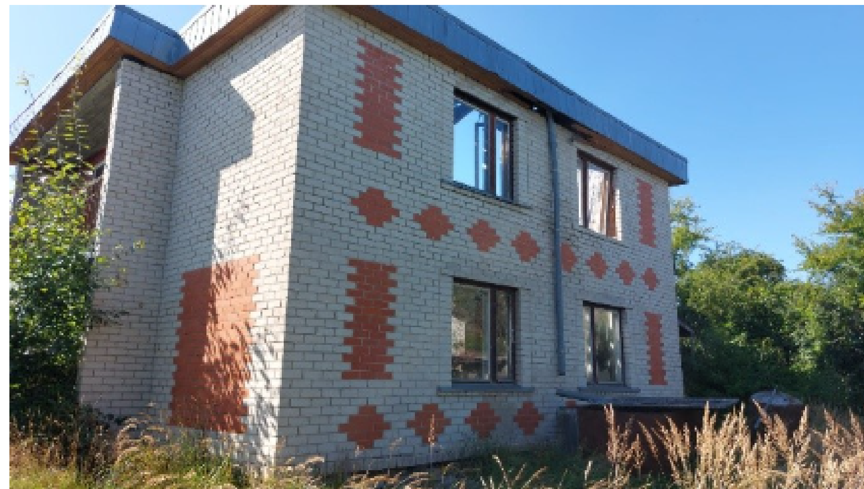
Ēka avārijas stāvoklī Pīlādžu iela 23, Sigulda
